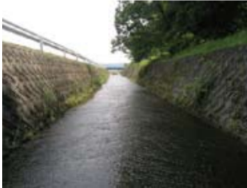
コンクリート3面張りのため、水生生物が流されてしまいます。
